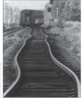
(Ejemplo 10.3) Expansión térmica. El calor extremo de un día de julio en Asbury Park, New Jersey, causó la deformación de estas vías.
