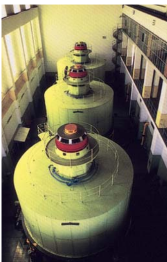
Turbinas que hacen girar los generadores eléctricos en una planta hidroeléctrica.
